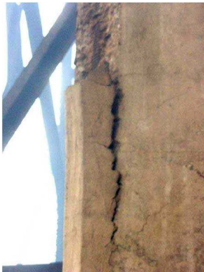
Figura 4: Spalling en pilar de concreto
