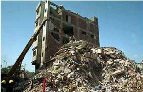
Figura 36 – Edificio en Alejandría después del incendio http://weekly.ahram.org.eg/2000/492/eg7.htm
