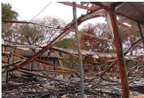
Figura 37 – Galpón de acero después de incendio Foto del autor
