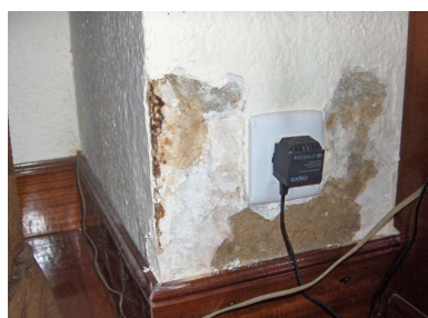
Humedad por capilaridad
