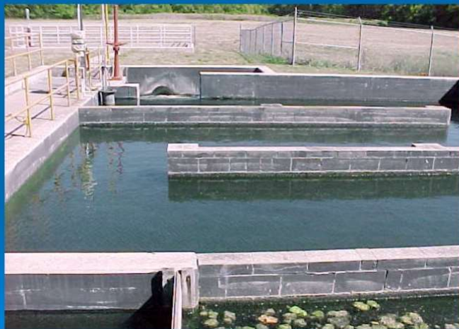
CÁMARA DE CONTACTO PARA CLORACIÓN
