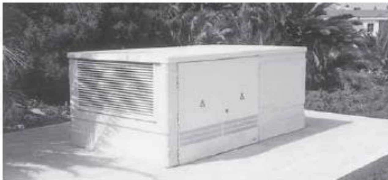
Fig. 1.24. CT compacto semienterrado.
