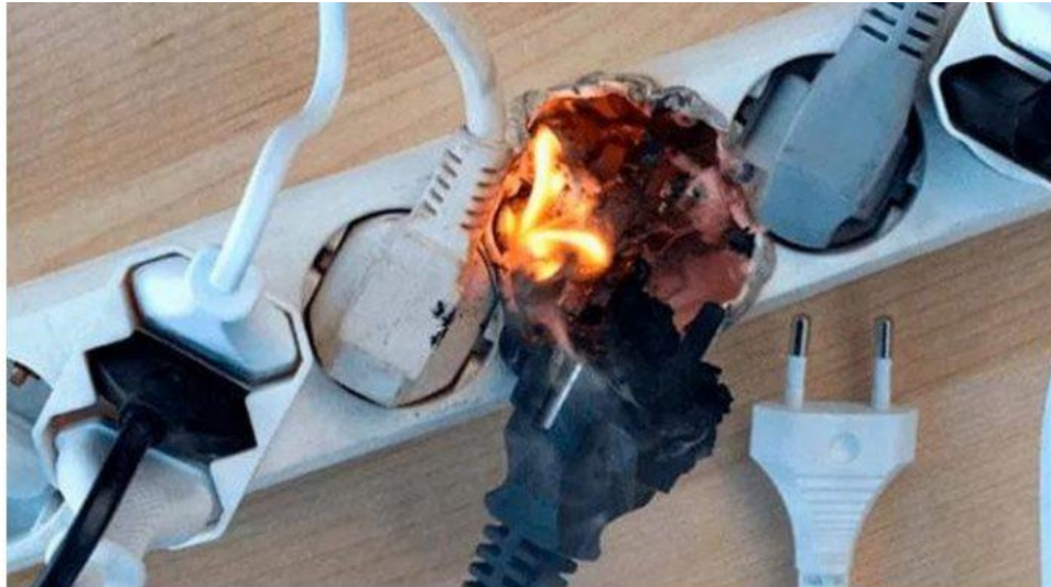
Disparo por sobrecarga de extensiones Eléctricas
