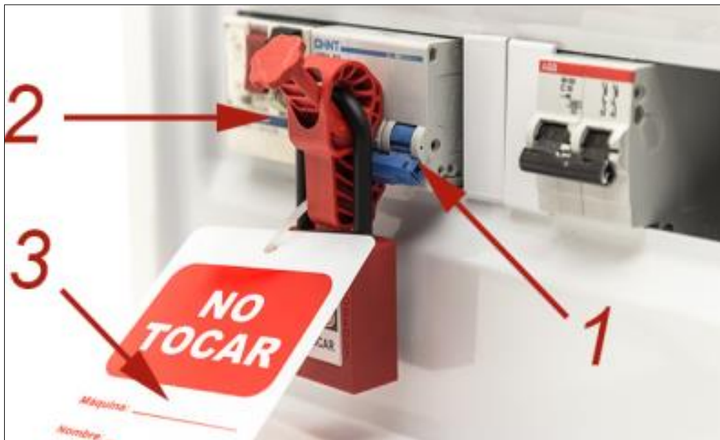
Figura 19. Señalización de caja eléctrica para maquina en mantenimiento. Fuente: Recuperado de https://www.sister-soft.com/blog/seguridad-industrial-lockout-tagout-loto/
