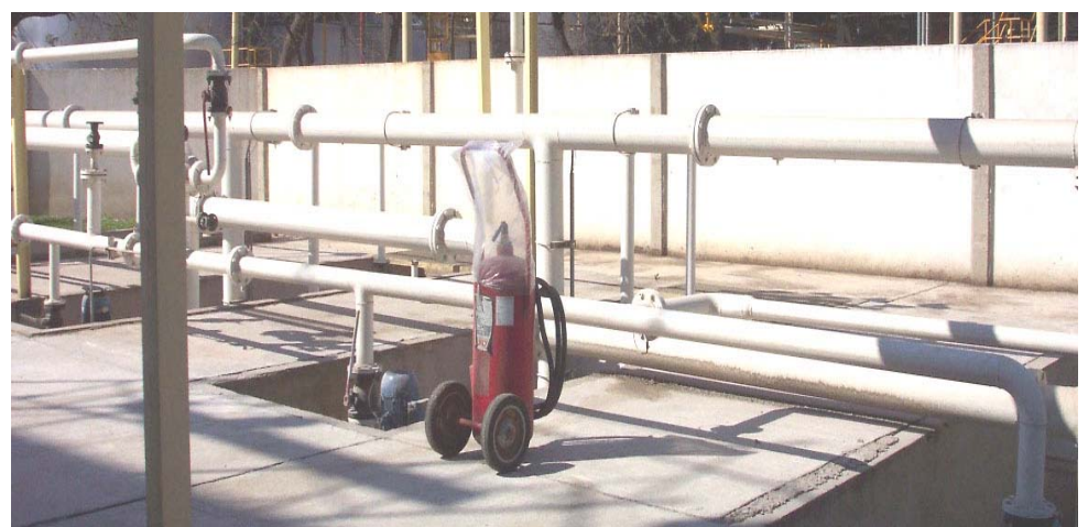
Unidades portátiles para extinción de fuego.
